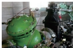
農業用減圧弁ユニット
