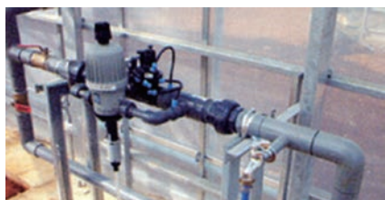
液肥混入器システム
