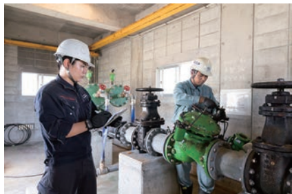
南城市農業用水管路水圧制御施設
