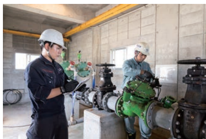
南城市農業用水管路水圧制御施設
